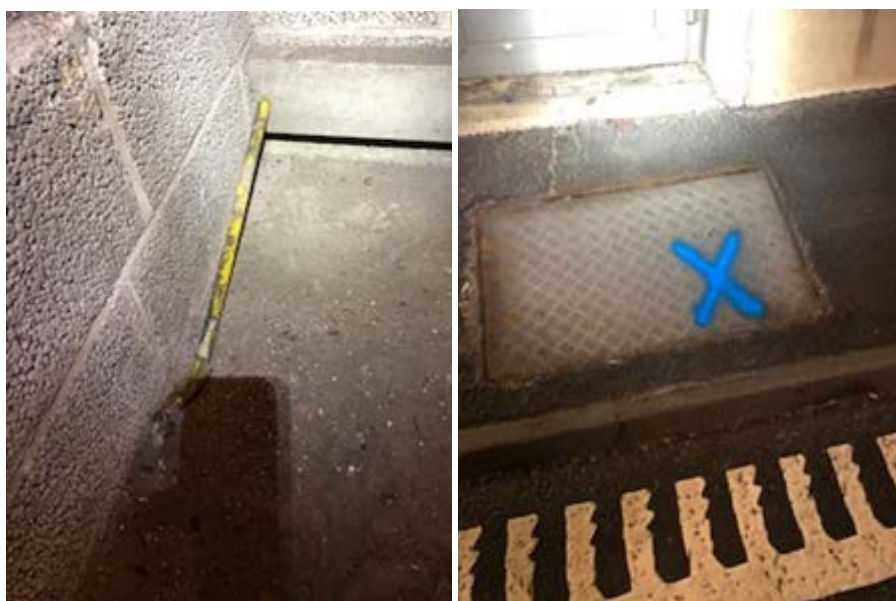
Figur 2.18 Funn i Nordbytunnelen.
