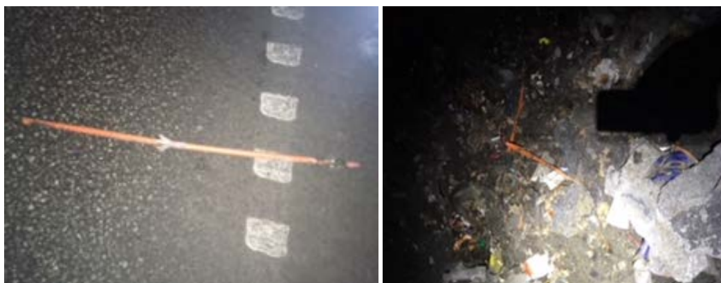
Figur 2.3 Funn av rør i Hovdetunnelen.
