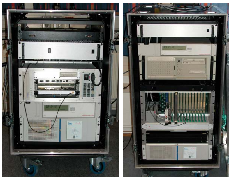
Figur 3.1 Bilde av sender- og mottagerrack. Sender til venstre
