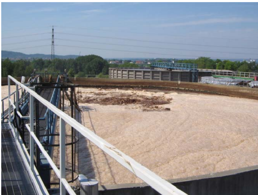
Figur 1.1. Luftebasseng ved Borregaards biologiske rensanlegg (foto: FFI juni 2006).
